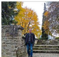
Ab hier ist alles gut“, sagt Stadtbauamtsleiter Christian Kopf über rund ein Drittel Mauer.
