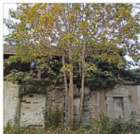
Bäume und Sträucher halten an vielen Stellen alleine die Mauer noch an ihrem Platz.
