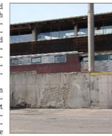
Die abgeplatzten Stellen an der Betonmauer müssen saniert werden.
