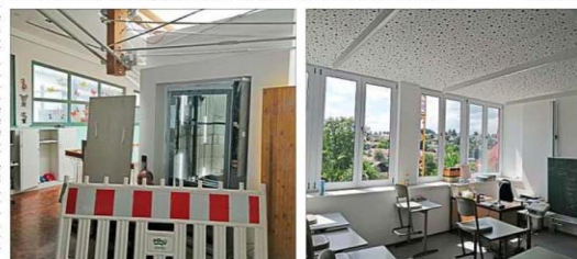
Der Aufzug wird gerade in Betrieb genommen.
